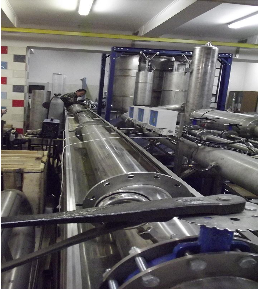
Fig. 3.5 Vista exterior de APU-011/600
